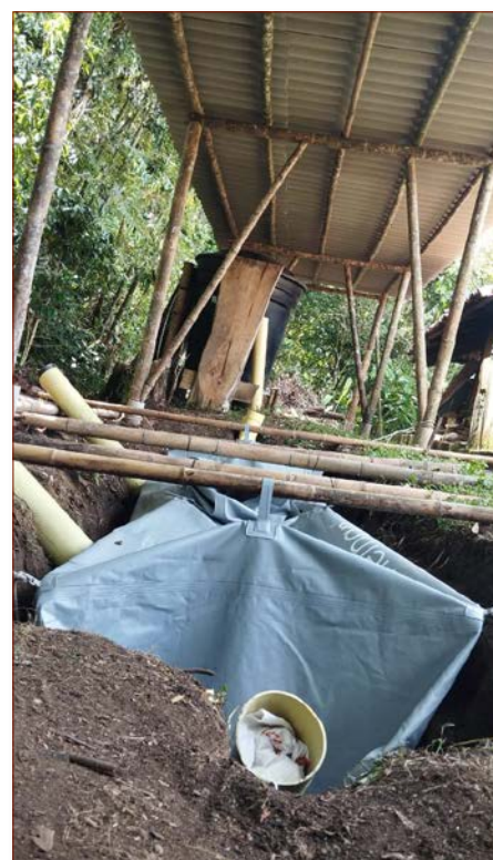
Dachgerüst aus guadua über der Grube des Biodigestors / Construcción para el techo de guadua sobre la fosa del biodigestor
